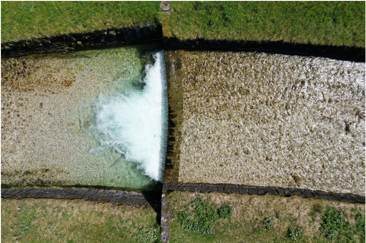
Abb. 1 Wenn ein Querbauwerk den Fluss unterbricht, sein Bett befestigt ist oder seine Ufer begradigt und verbaut sind, kann er nicht frei fließen. © L. Kirchgässner, blattfisch
